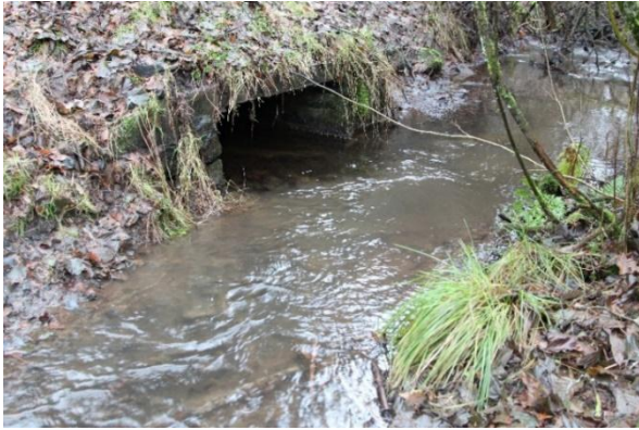
Abbildung 48: Graben westlich des Dammweges am zweiten Durchlass
